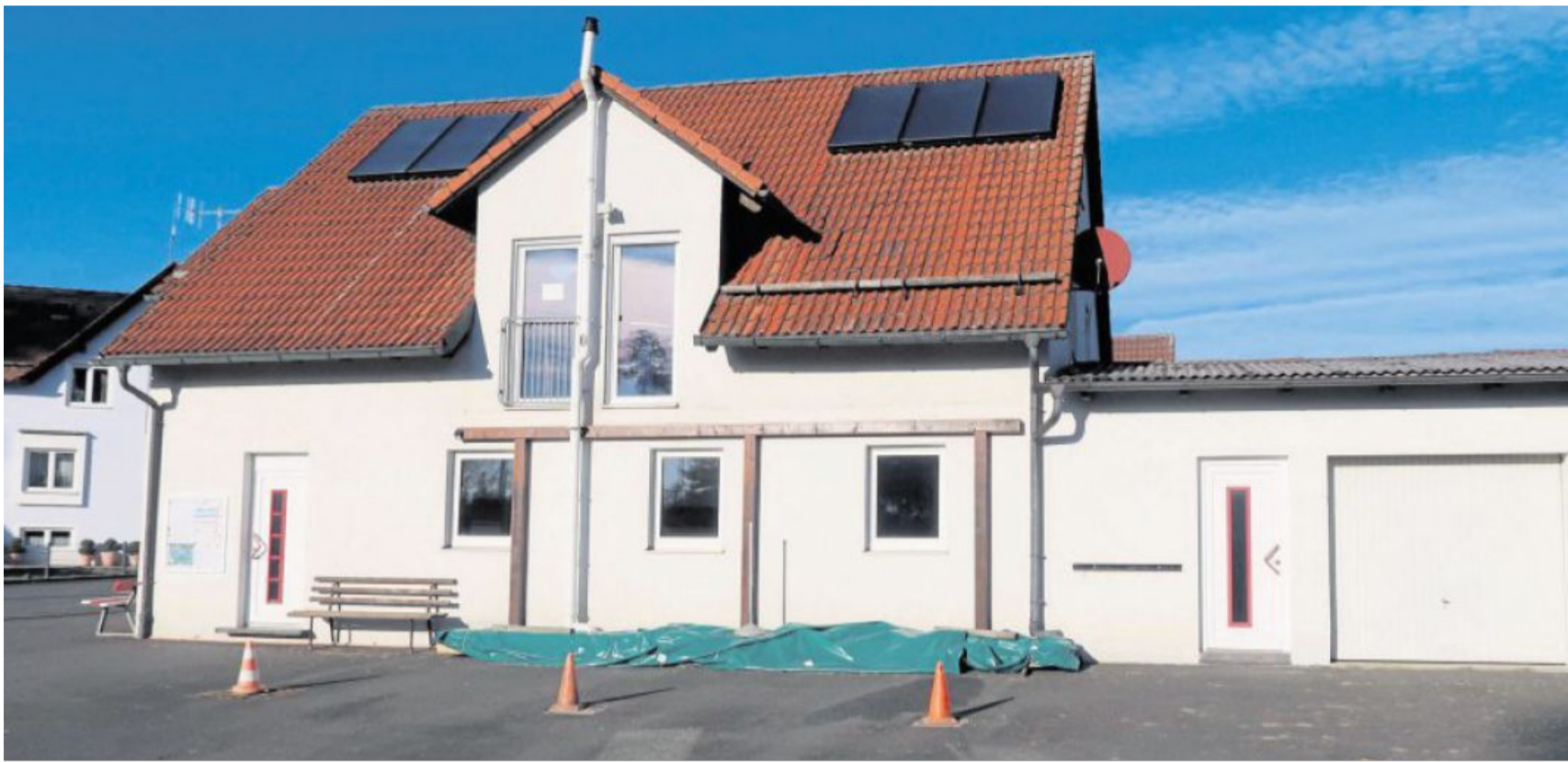
Auch im Jubiläumsjahr investiert der Turn- und Sportverein in seine Sportanlagen und das Sportheim. Abgerissen wurde bereits der Balkon vor dem Sportheim. Ein neuer großer Balkon wird im Frühjahr errichtet. Bild: bsc
